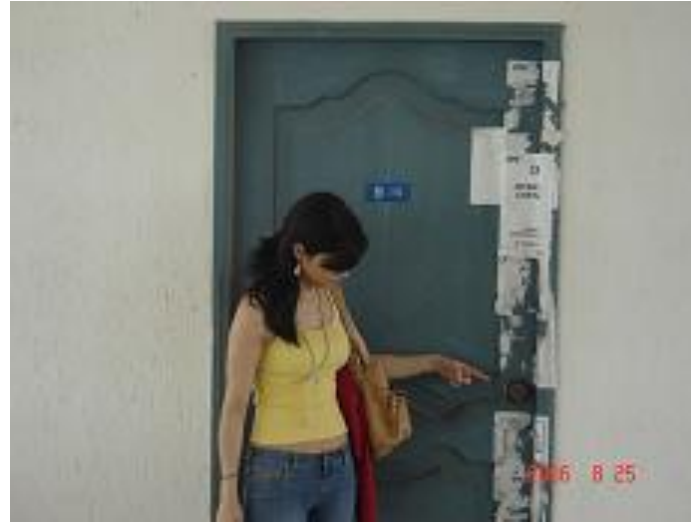
Chapas de puertas oxidadas
