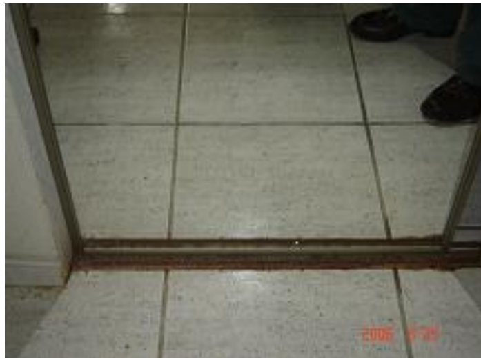
Corrosión en los rieles del closets
