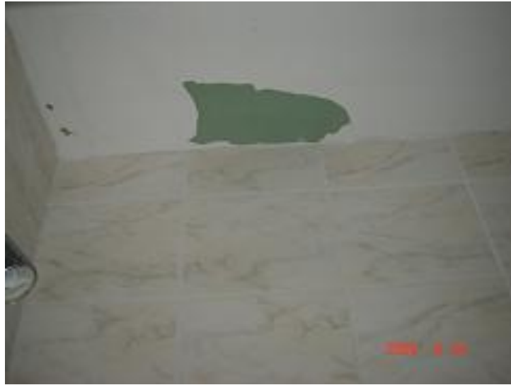
Ciertas paredes necesitan corrección de pintura
