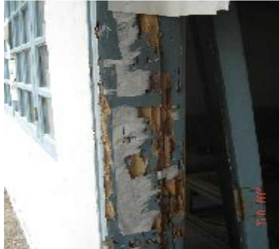
Deterioro de molduras y batientes en las puertas de Las habitaciones
